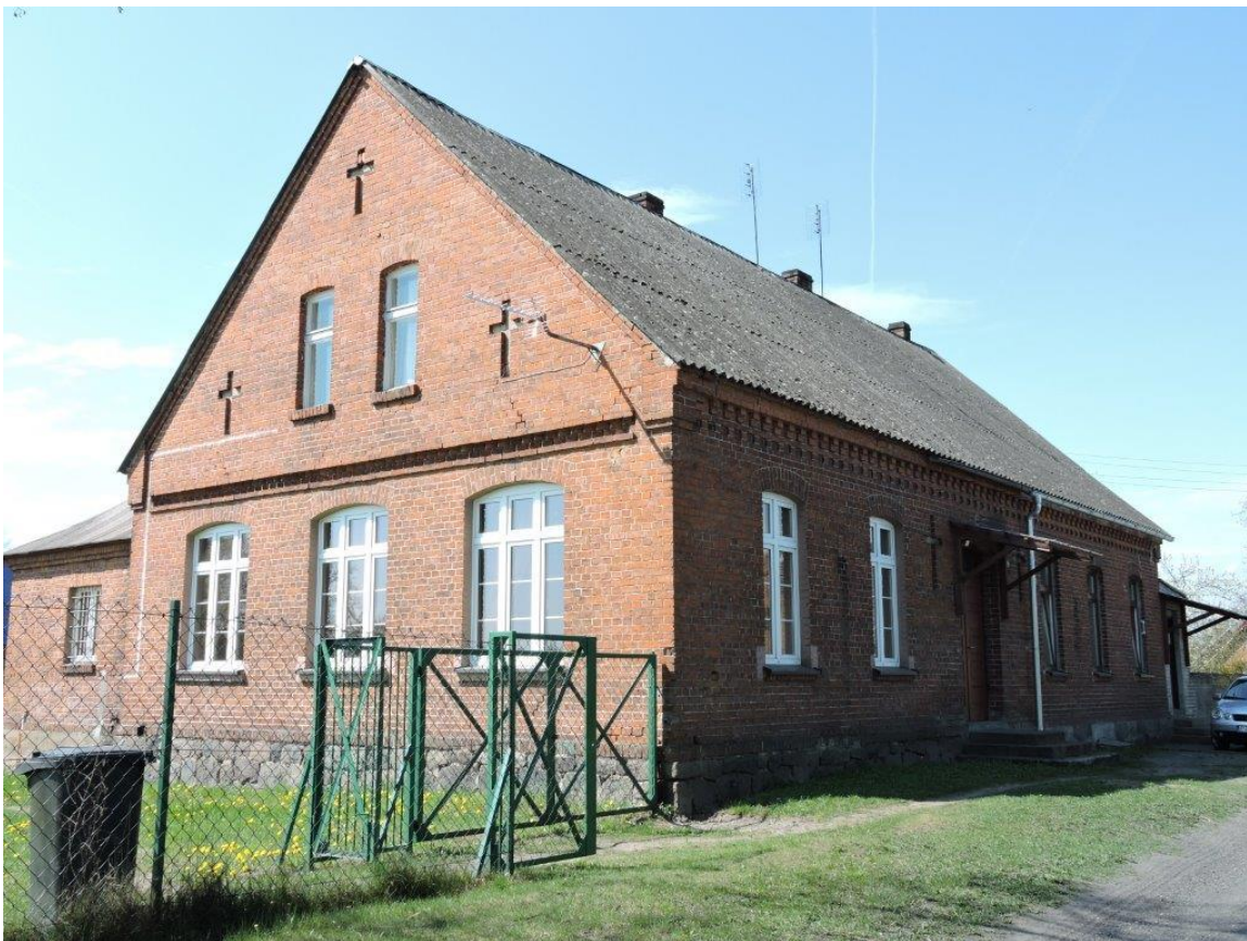
Rysunek 24 Wymagająca remontu sala wiejska w Starym Dzierżaniu (źródło: Urząd Gminy Złotów)
